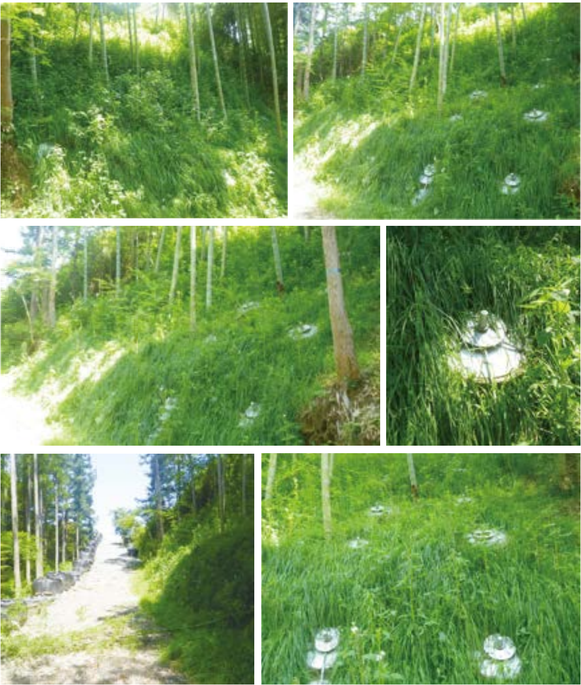
受圧板や鋼材が隠れる程緑化しています。
