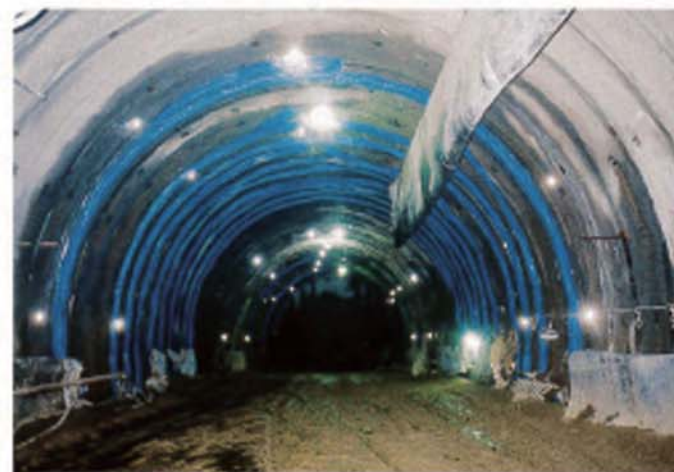
トンネル裏込排水
