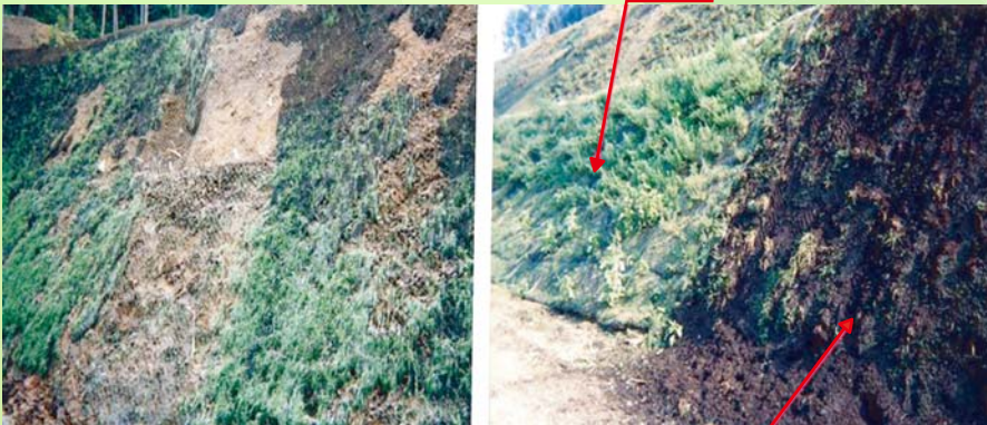
雨水により基盤材が流亡 ラス網が露出している。 崩落した厚層基材吹付工
