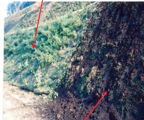
MAXグリーンラグ工法 ® 崩落した厚層基材吹付工
