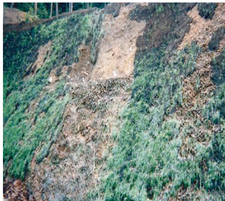
雨水により基盤材が流亡 ラス網が露出している。
